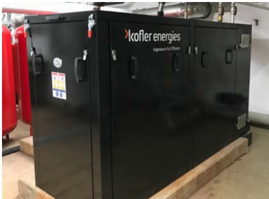
Blockheizkraftwerk im Diakoniezentrum Bethesda Eisenberg
